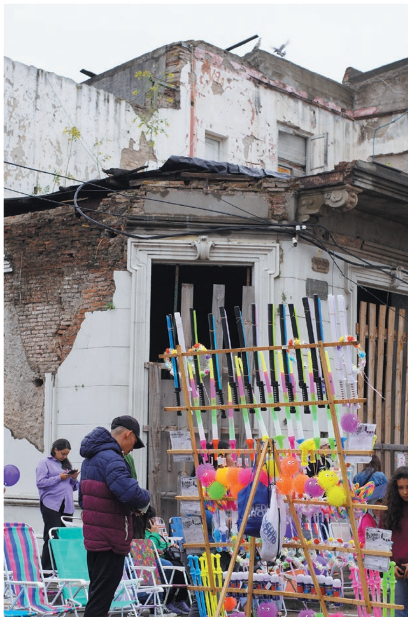
Registro de edificio dañado por el tornado. Fotografía de Eloísa Casanova, tomada en la Fiesta de la Primavera de octubre de 2024
